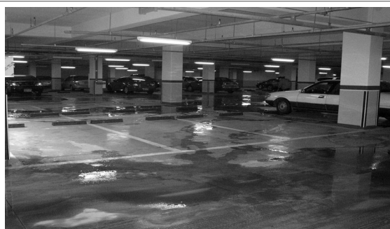
[그림 19] 지하주차장 바닥에 물이 흥건한 상태
