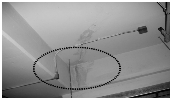
[그림 17] 지하주차장 슬라브 균열 누수
