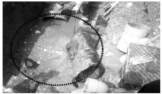
[그림 14] 지반침하에 의한 우수관 파손, 악취 발생
